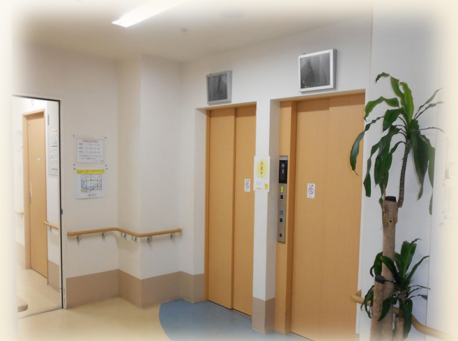
エレベーター
